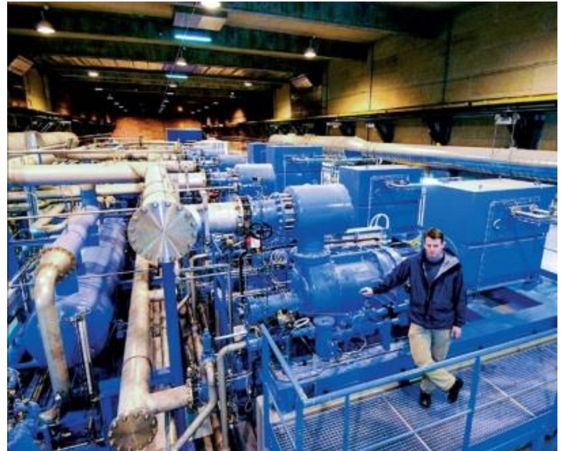
Station de compression CERN pour le LHC
