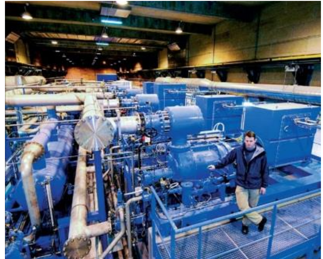
Station de compression CERN pour le LHC
